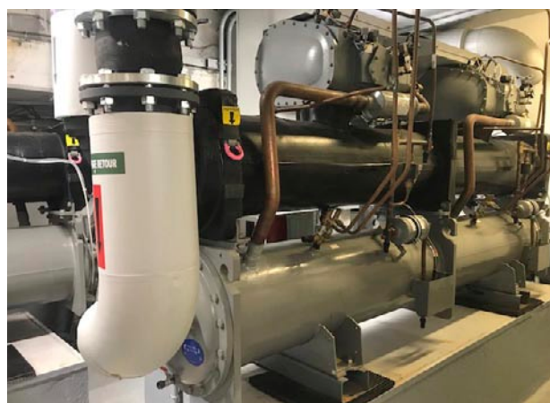
Pompes à chaleur du stade nautique Rainier III.
